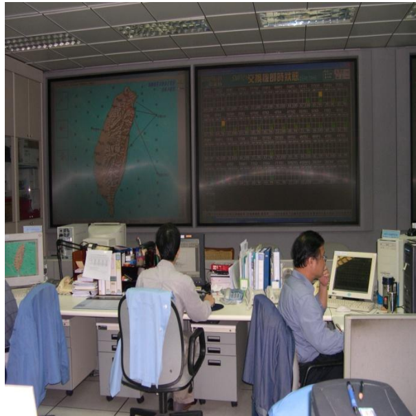
內勤工程人員集中監控電信系統是否正常運作
