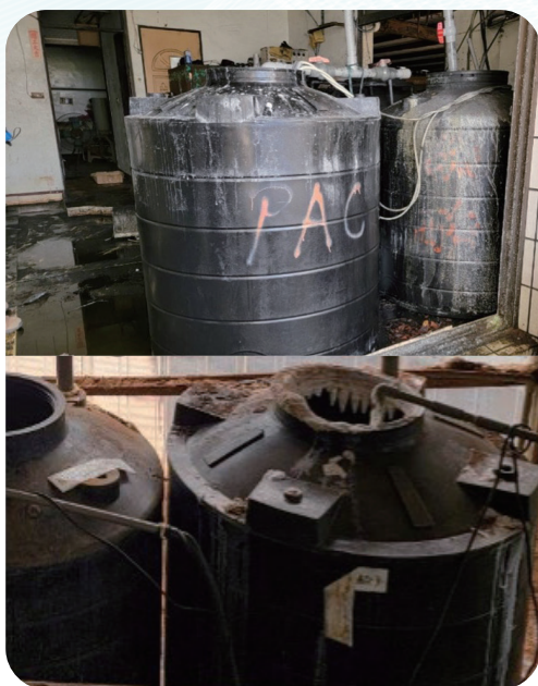
▲ 圖4：A公司二樓聚氯化鋁（即PAC）、氫氧化鈉（即液鹼）、次氯酸鈉（即漂白水）等化學品水溶液儲槽，皆未依規定於容器上明顯標示危害圖示與其相關內容。
