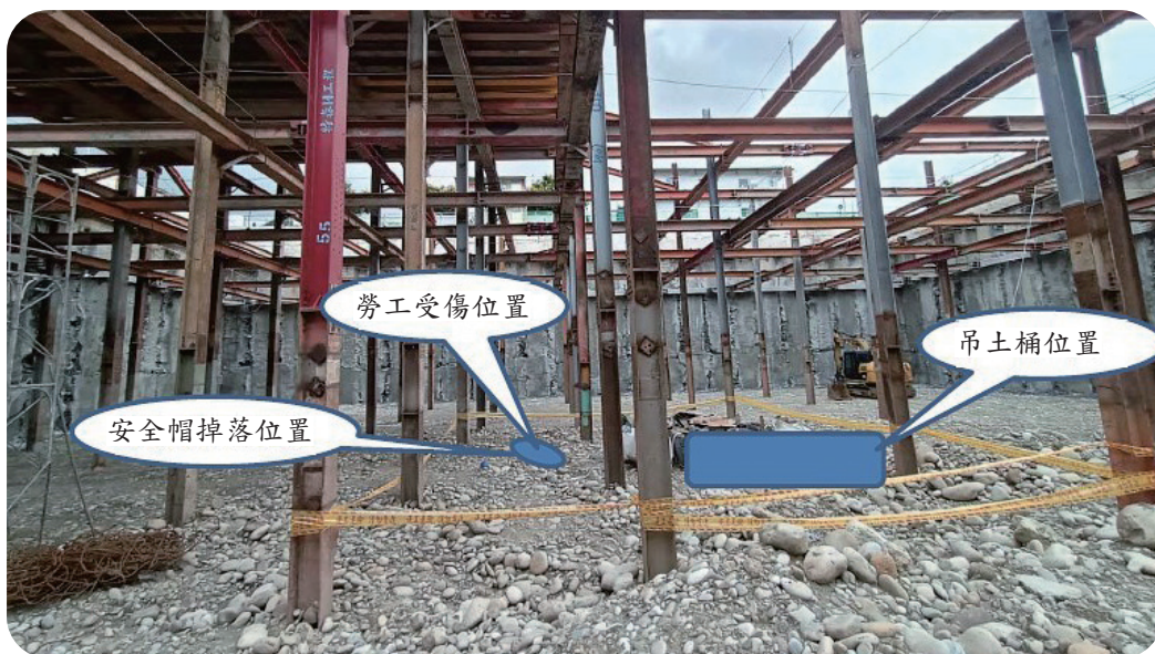
▲ 圖 3：土方吊運作業未採取防止吊掛物通過人員上方及人員進入吊掛物下方之設備或措施肇災
