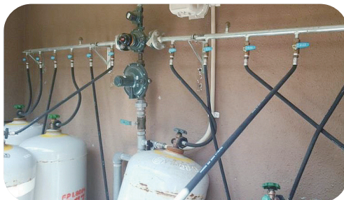
▲ 圖 2：颱風水災後液化石油氣容器傾倒
