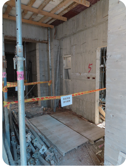
▲ 圖 2：模板護蓋未能防止掀起，且表面未漆以黃色並書以警告訊息肇災
